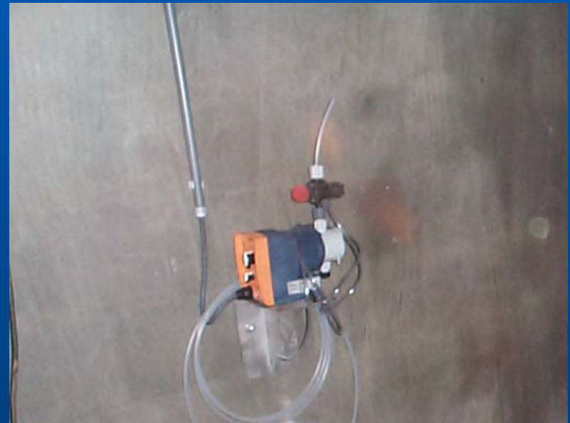
Chemicaliëndoseerpomp voor fosforverwijdering
